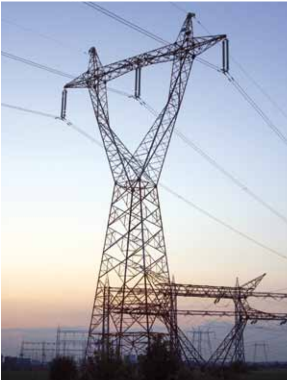
Un réseau régional de Haute Tension, véritable «autoroute» électrique depuis la centrale de Jerada
